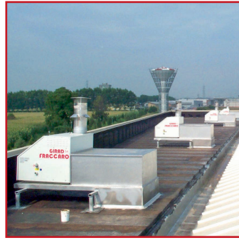
Installazione a tetto Roof installation
